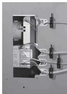
Branchement connecteur au boîtier électrique
